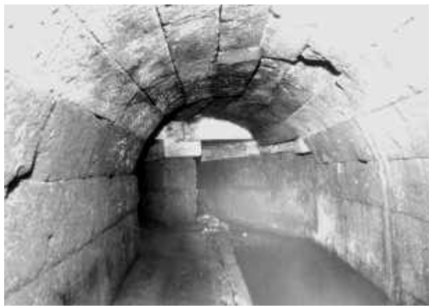
Wiederzusammenführung der Abwasserströme der Cloaca Maxima unter der Basilika Julia (Nr. 17, Blick stromauf)
